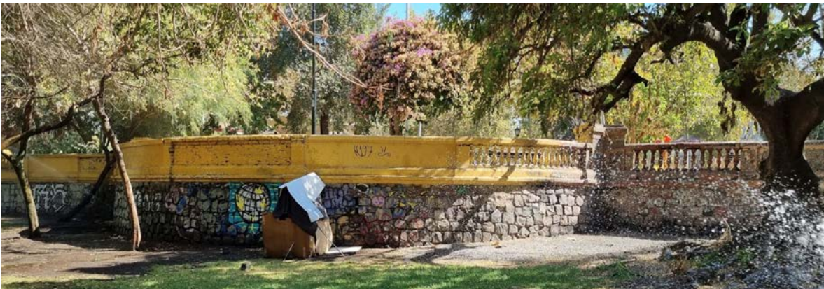
Figura 211. Murete en lo que fue la terraza que sirvió como encalladero, pintado de color amarillo. Se debiese mantener su color original a la vista. Fuente: archivo ONG Poloc 2023.
