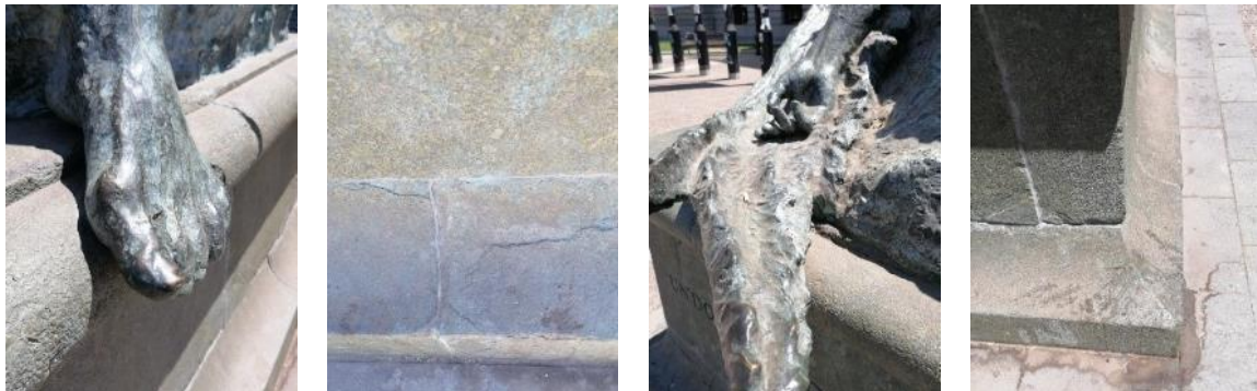
Figura 80. Alteraciones y deterioros presentes en la escultura “Unidos en la gloria y en la Muerte”, realizada por la escultora Rebeca Mate. a) Abrasión por contacto, pérdida de la pátina; b) Deplacación de la piedra del pedestal; c) Depósito de suciedad superficial y adherida; d) Orines y suciedad en el pedestal. Fuente: archivo ONG Poloc 2022.
