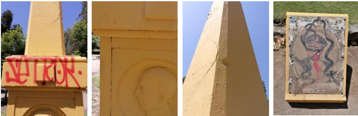
Figura 72. Alteraciones y deterioros presentes en el obelisco “Escritores de la Independencia”, cuyos medallones fueron realizados por el escultor Nicanor Plaza. a) Grafitis; b) Pintura sobre medallones; c) Pérdida de materia recubierta por las capas de pintura; d) Elementos adheridos, grafitis sobre placa de identificación municipal. Fuente: archivo ONG Poloc 2022.
