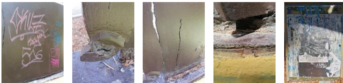
Figura 73. Alteraciones y deterioros presentes en escultura “Pueblo”, realizada por el escultor Osvaldo Peña. a) Grafitis; b) Pérdida de materia y roturas por corrosión; c) Fracturas del fierro en la zona inferior; d) Corrosión del fierro en zona inferior de unión con la base; e) Elementos adheridos, grafitis sobre placa de identificación municipal. Fuente: archivo ONG Poloc 2022.
