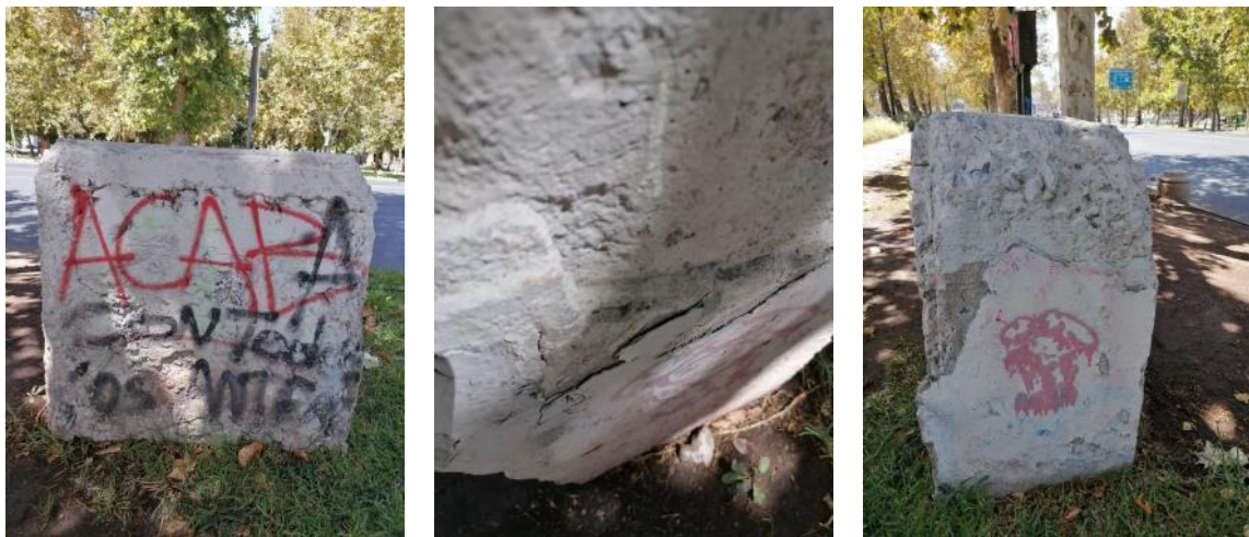
Figura 71. Alteraciones y deterioros presentes en monolito a Vicente Huidobro. a) Graffitis y elementos adheridos. Pérdida de morfología e inscripciones; b) Deplacamiento de los revestimientos; c) Pérdida de materia en zona superior derecha. Fuente: archivo ONG Poloc 2022.
