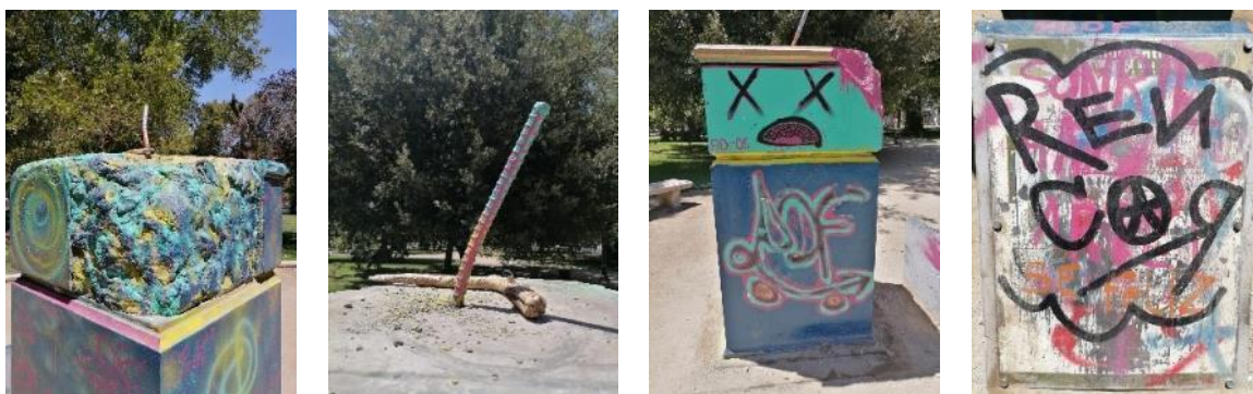
Figura 75. Alteraciones y deterioros presentes en el pedestal de la escultura de “Abraham Lincoln”, realizada por el escultor Henry K. Bush-Brown. a) Pérdida de materia en zona superior del pedestal; b) Vástago de anclaje que tuvo el busto; c) Grafiti; d) Elementos adheridos, grafitis sobre placa de identificación municipal. Fuente: archivo ONG Poloc 2022.
