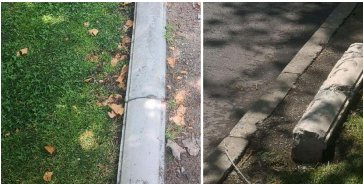
Figura 43. Fotografías de soleras y bordillos más representativos y con mayor presencia en el Parque Forestal. Fuente: archivo ONG Poloc 2021.
