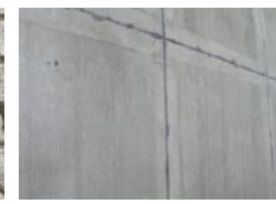
RECOMENDABLE: PAVIMENTO DE CEMENTO
