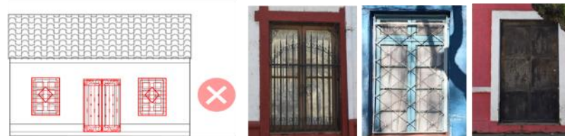
Protecciones NO RECOMENDADAS con sobrediseño, que sobrepasan el vano y el uso de postigos metálicos
