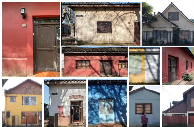
Imágenes 42: Situación actual de pinturas en fachadas del sector B.
