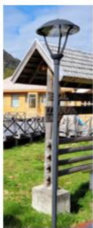
Luminaria de acero
