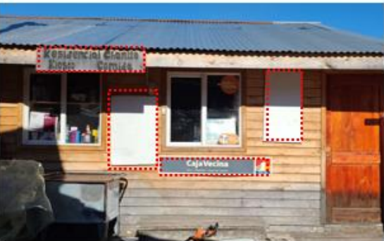
Publicidad desorganizada, alterando la cohesión visual de la fachada.
