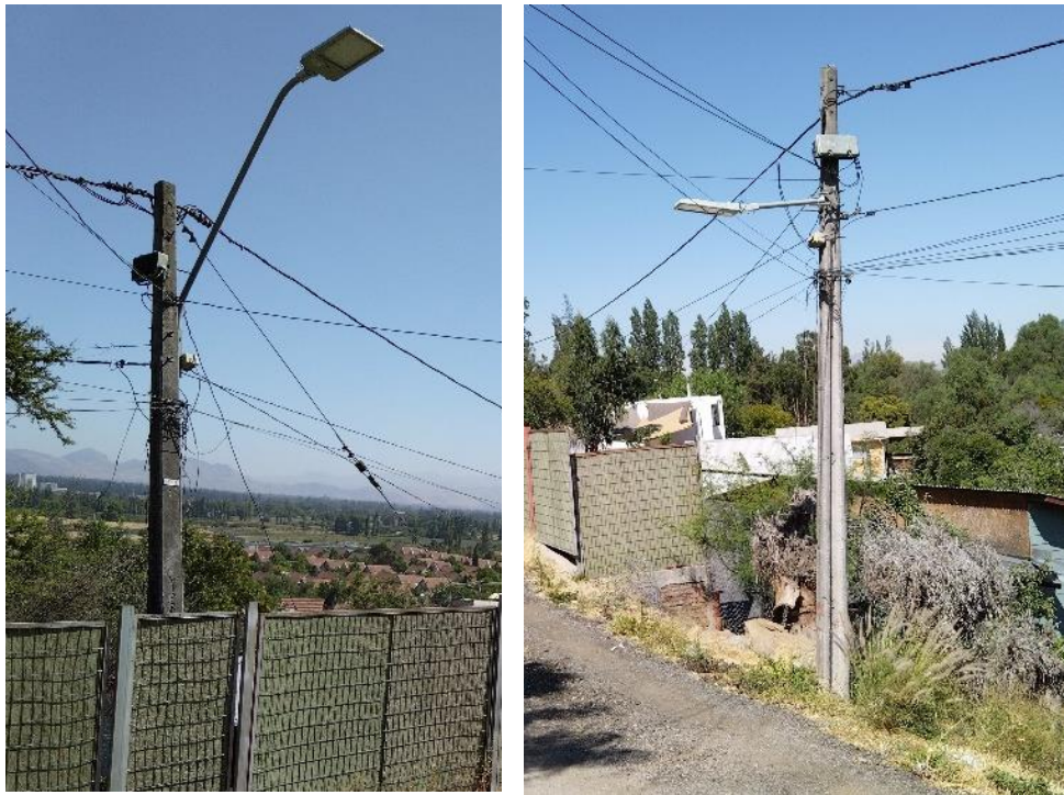
Pie de figura. Luminaria existente de la ZT. Fuente: ST CMN, 2024.
