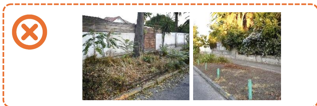
Fig. 393: Ejemplo de veredones en mal estado de conservación en la ZT. Fuente: Consultora Mireya Danilo (Equipo: Mireya Danilo, Cristina Briño y Fernando Navarro).
