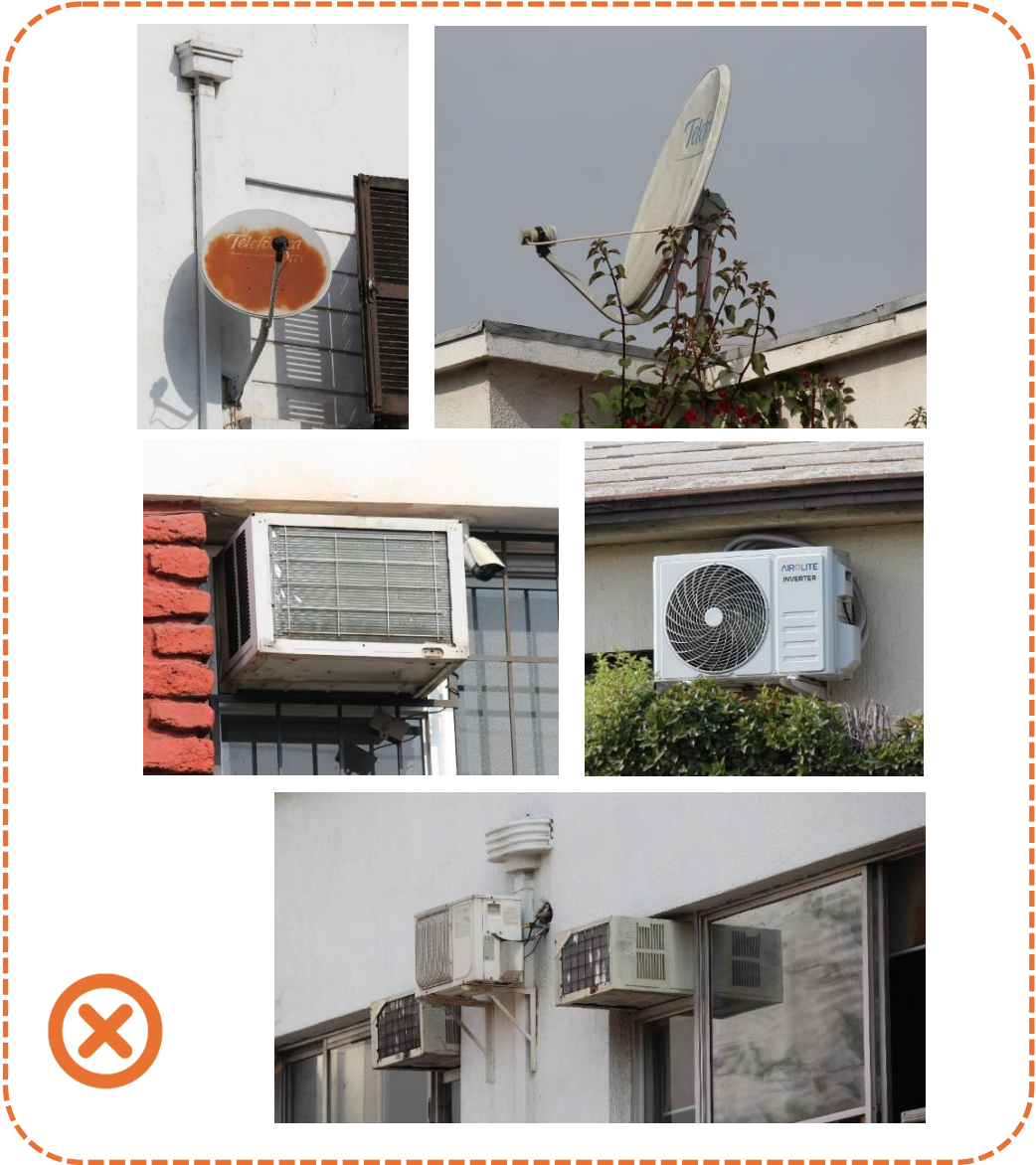
Fig. 304: Elementos discordantes no permitidos, existentes en la ZT. Fuente: Consultora Mireya Danilo (Equipo: Mireya Danilo, Cristina Briño y Fernando Navarro).
