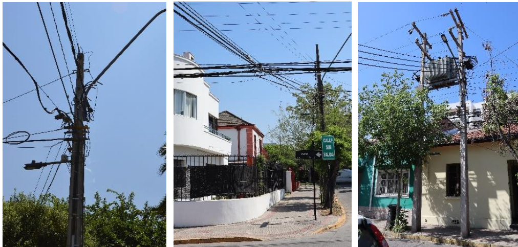
Fig. 115 - 117: Cableado urbano presente en la ZT. Fuente: Consultora Principios Patrimonio Chile.
