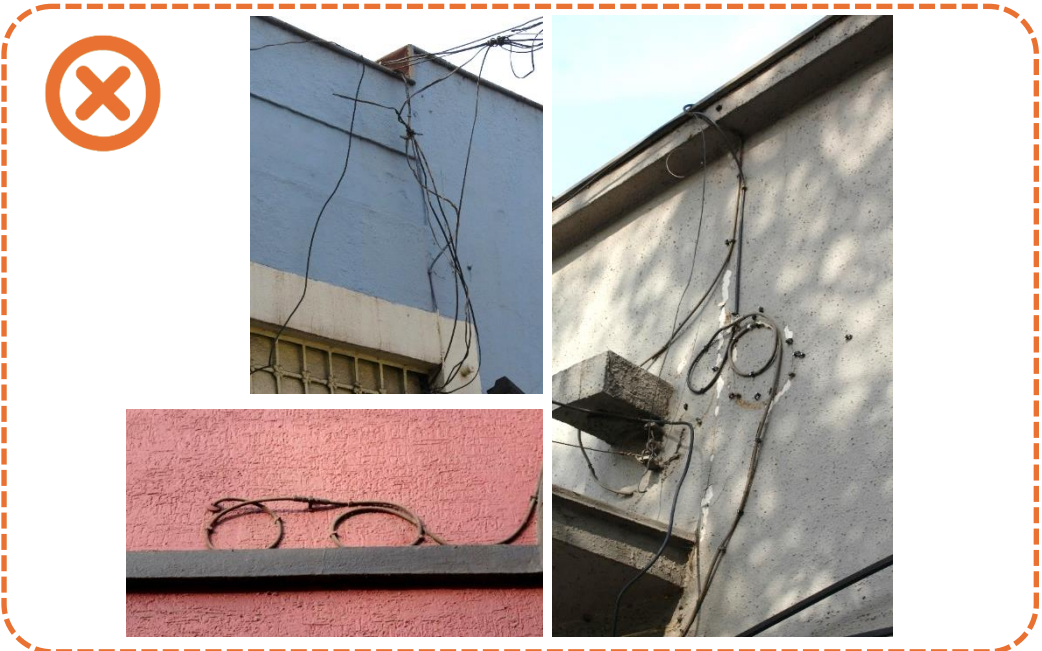
Fig. 309: Ejemplo de cableado existente en inmuebles de la ZT. Fuente: Consultora Mireya Danilo (Equipo: Mireya Danilo, Cristina Briño y Fernando Navarro).
