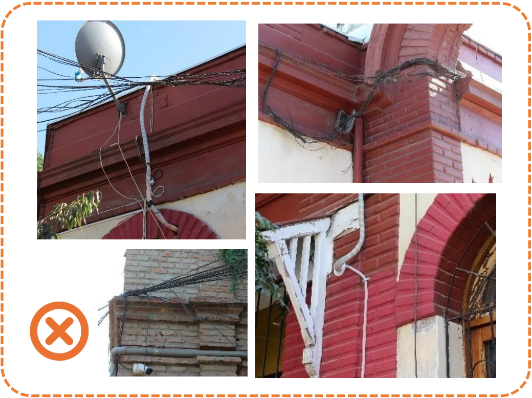
Fig. 147: Ejemplo de ubicación de cableado existente en inmuebles de la ZT. Fuente: Consultora Mireya Danilo (Equipo: Mireya Danilo, Cristina Briño y Fernando Navarro).
