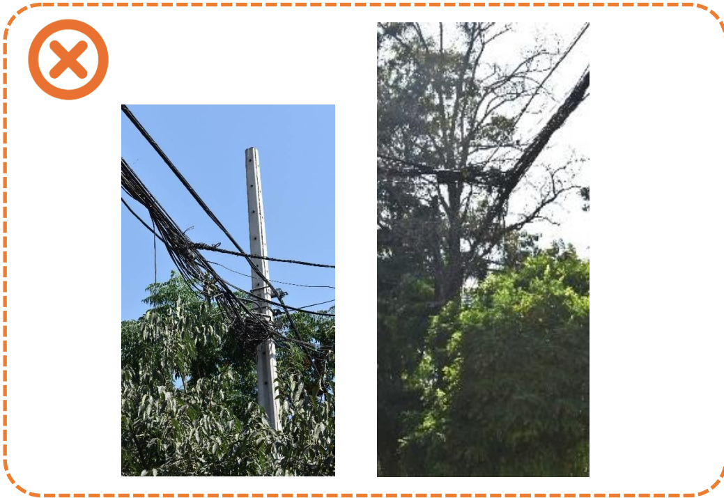
Fig. 192: Cableado aéreo existente en la ZT. Fuente: Consultora Mireya Danilo (Equipo: Mireya Danilo, Cristina Briño y Fernando Navarro).
