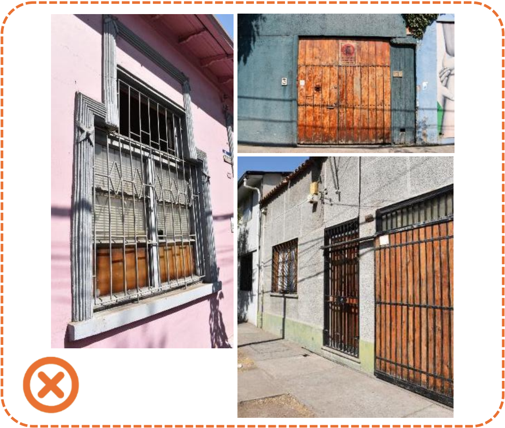
Fig. 257: Ejemplo de alteración en vanos originales. Fuente: Consultora Mireya Danilo (Equipo: Mireya
