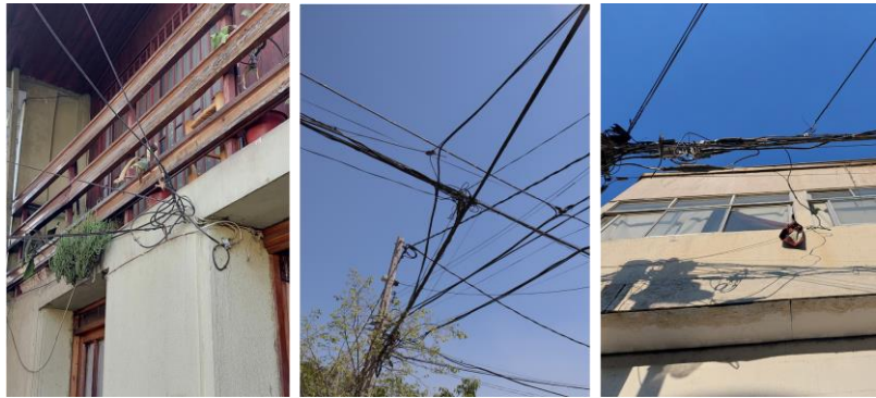
Fig. 72 - 74: Cableado urbano presente en la ZT. Fuente: Consultora Principios Patrimonio Chile.
