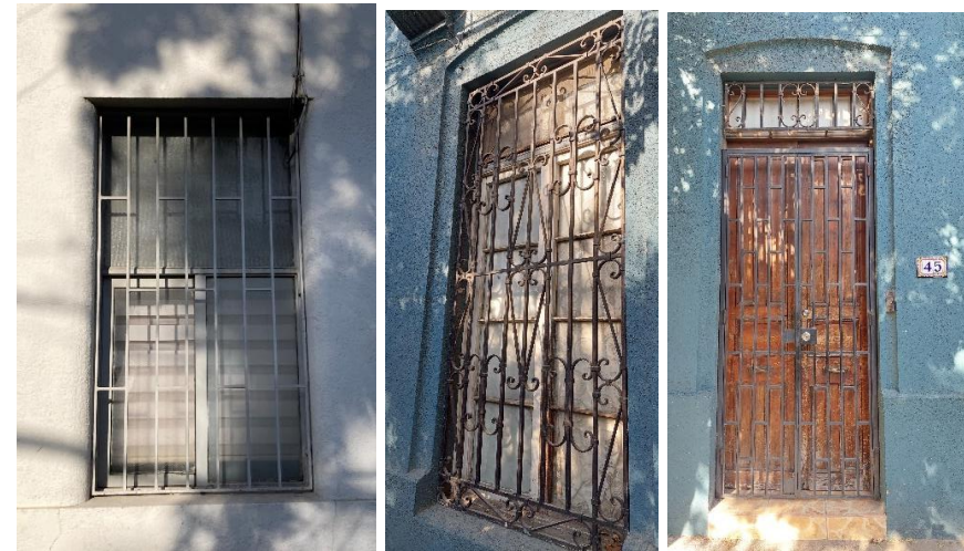
Fig. 223 - 226: Ejemplos de inmuebles con alteración que afecta. Fuente: Consultora Principios Patrimonio
