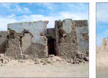
Restos de las Ruinas
